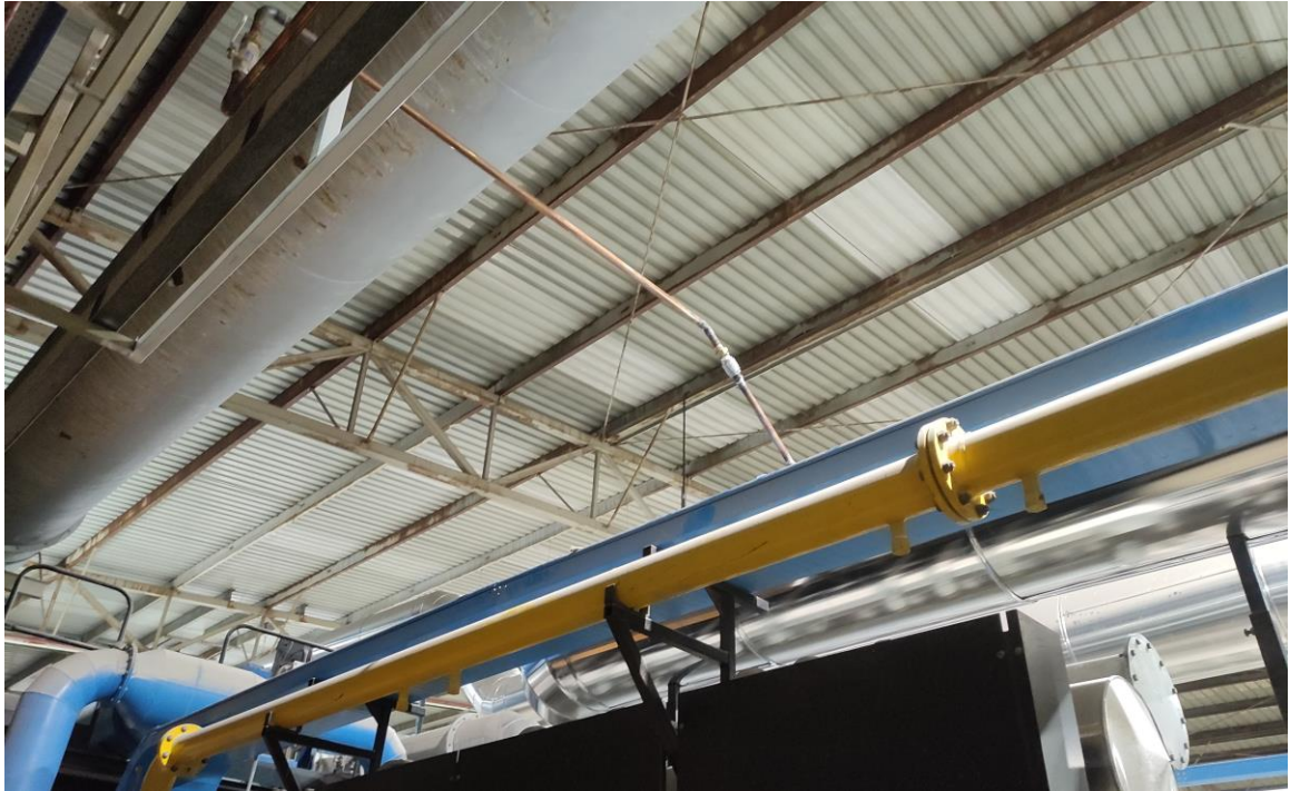
Figura 7. Inyección de oxígeno en una de las conducciones de aire de combustión.
