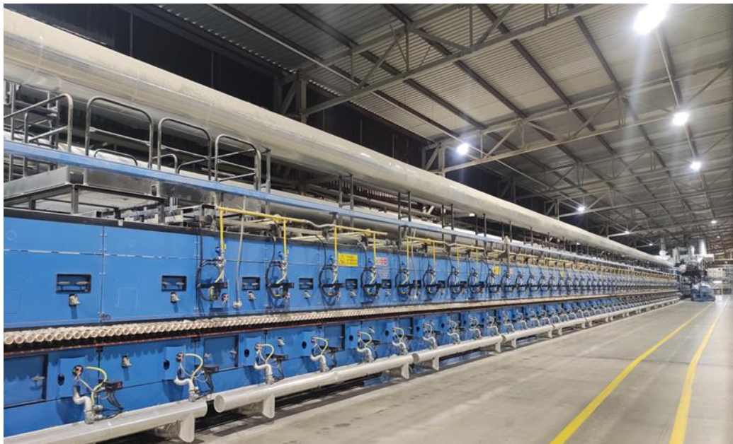
Figura 2. Imagen general del horno industrial donde se ha realizado el trabajo.
