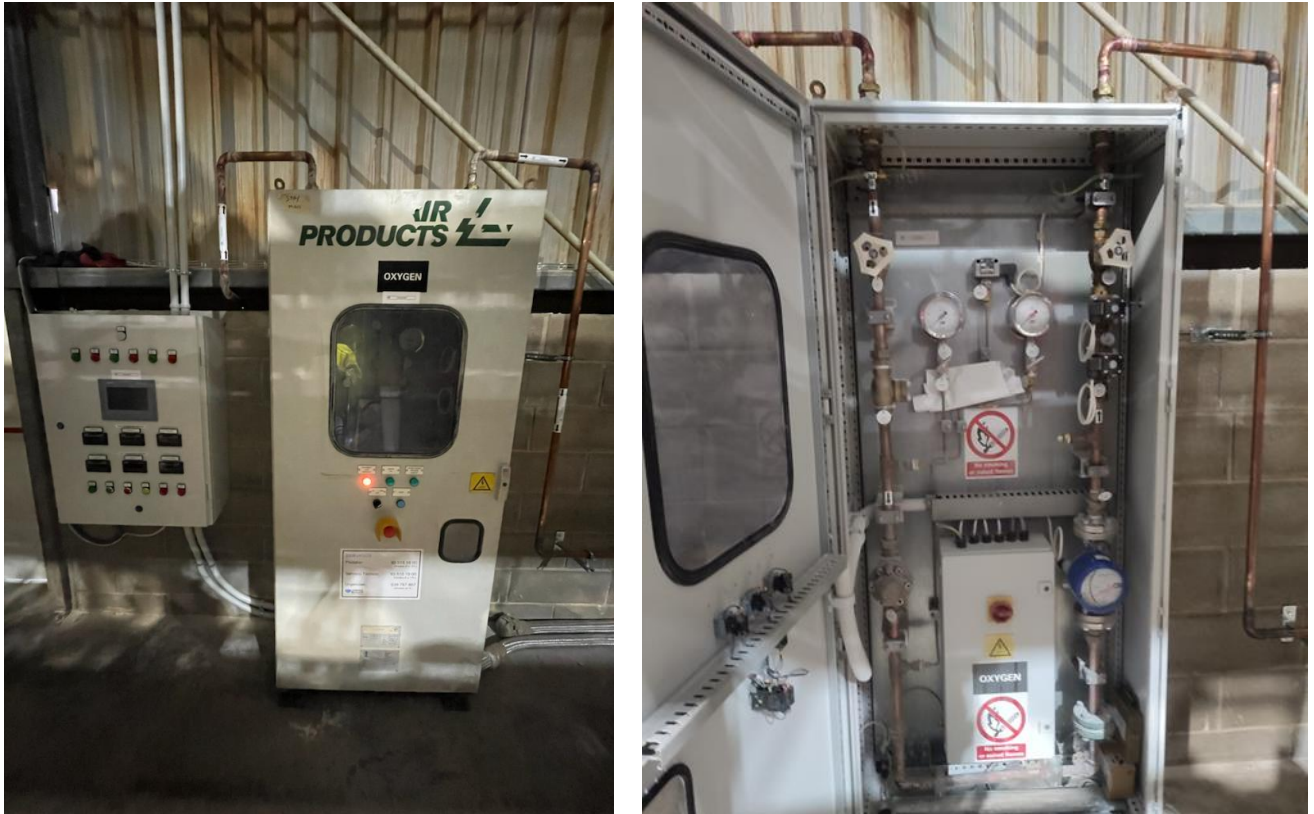
Figura 4. Sistema de regulación y control de la entrada de oxígeno (SKID)
